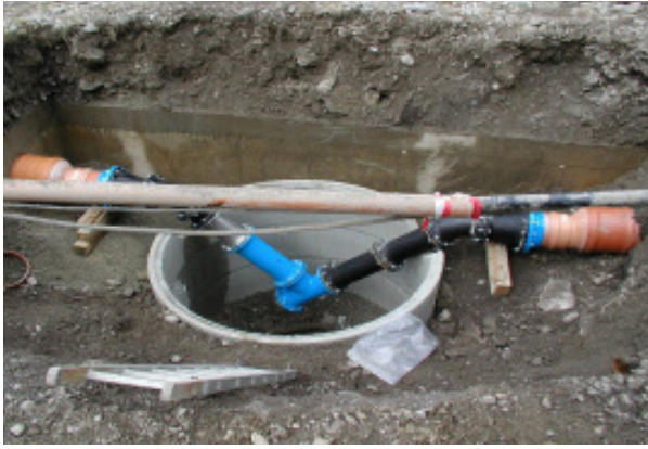
Abbildung 1: Induktive Durchflussmessung Alfutzquelle
